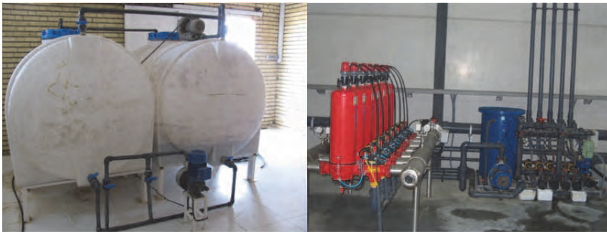
شکل ۲۱- تأسیسات آبیاری در گلخانه
